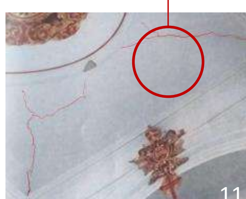
Imagen 11. Grietas en la falsa bóveda / Cracks in the false vault . Fuente/ los autores/ the authors
