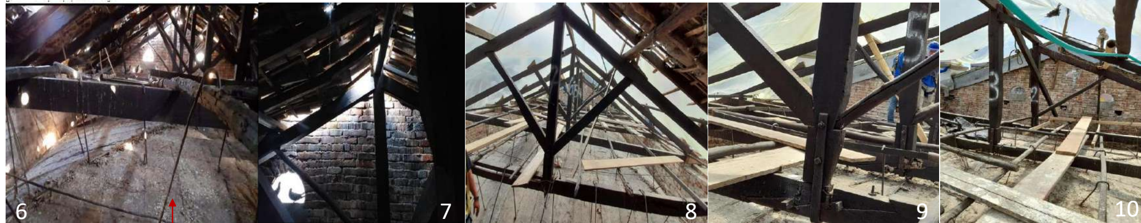
Imagen 5-10. Estado de la cubierta y la bóveda falsa antes de la intervención / Condition of the roof and false vault before the intervention . Fuente/ source: Evangelista Nieto Devia
